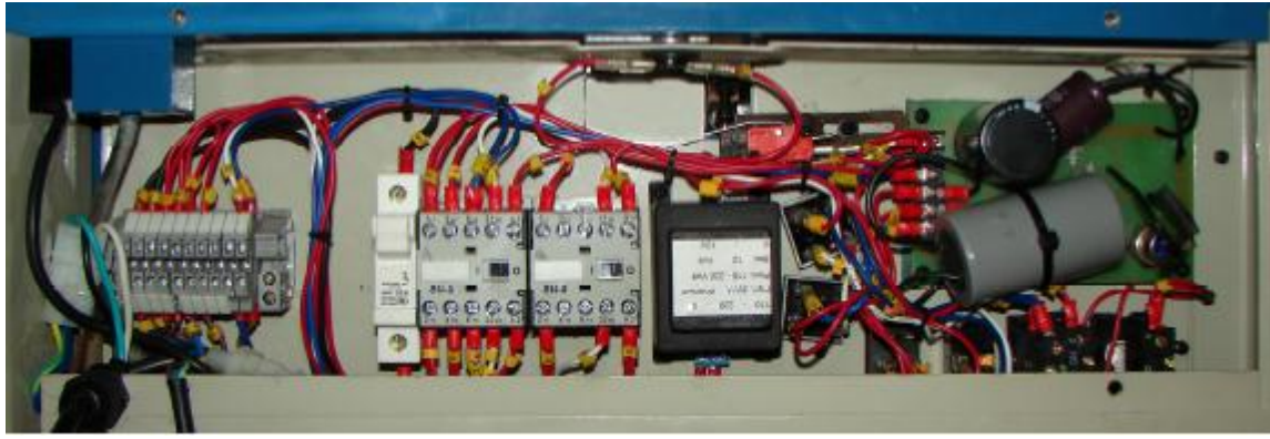
Schaltschrank, ohne Abdeckung
